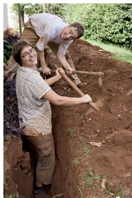
Beim Bau des ersten Blitzschutzes an unserem eigenen Haus legten wir selbst mit Hand an.
